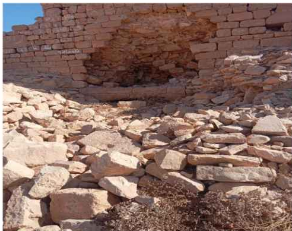
شكل 20: يوضح مدخل القصر الرئيسي المغلق نتيجة الركام المحطم عليه المصدر: تصوير الباحث
